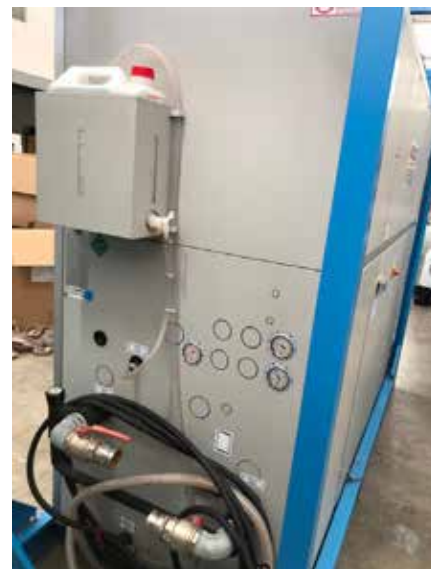
Groupe à eau glacée IPR (vue raccords)
