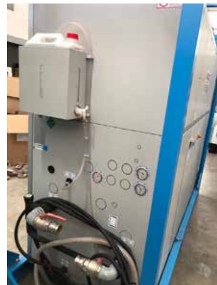
Groupe à eau glacée IPR (vue raccords)
