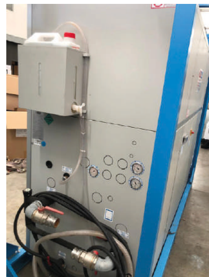
Groupe à eau glacée IPR (vue raccords)
