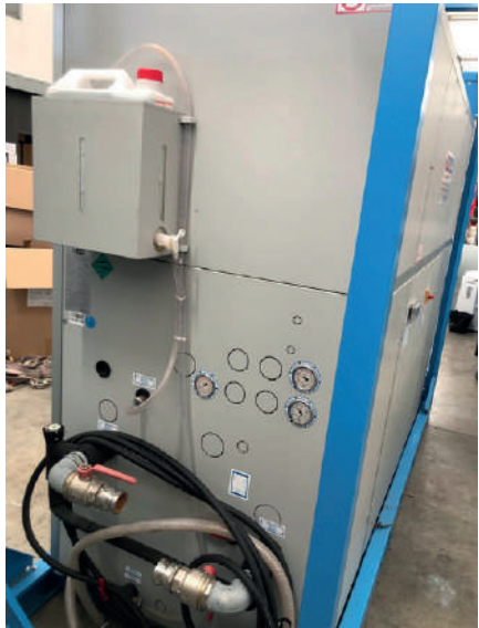
Groupe à eau glacée IPR (vue raccords)
