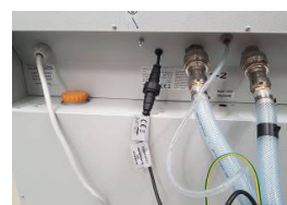
vue arrière connectique
