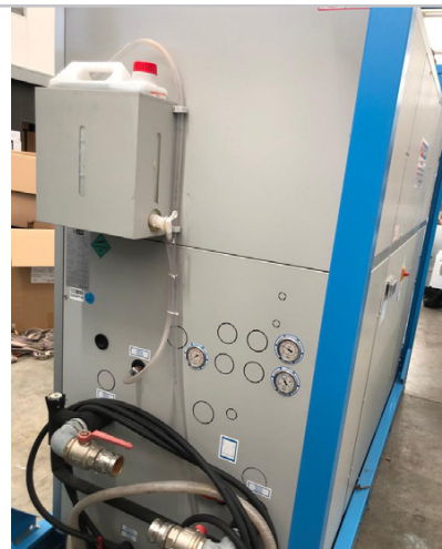
Groupe à eau glacée IPR (vue raccords)
