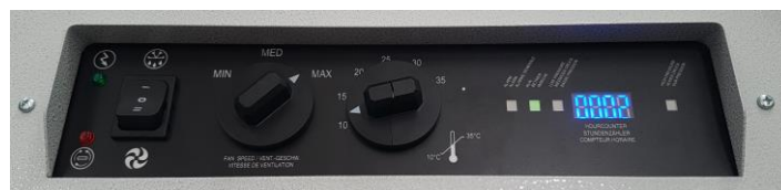
PANNEAU DE CONTROLE
